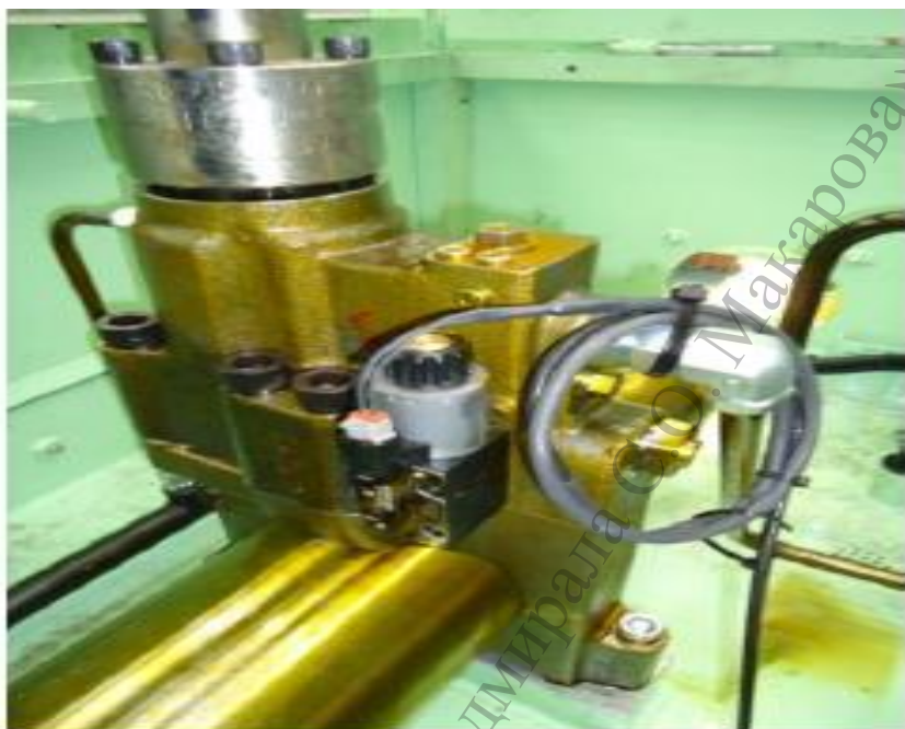
Рисунок 2.55 - Магистраль сжатого масла оснащена двумя датчиками заданного давления под управлением от ССМ-20 #3 и #4.
